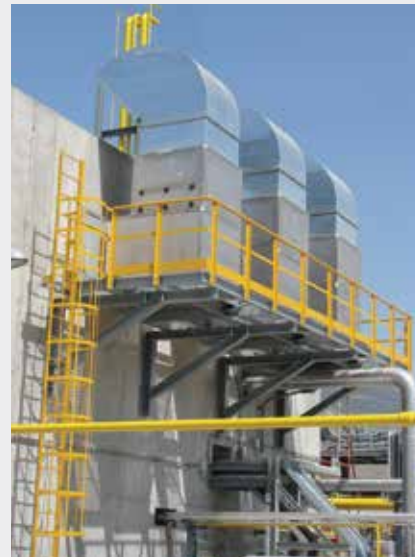
Κλιματισμός Εργοστασίου Ενέργειας Elpedison στη Θήσβη Βοιωτίας (2010) ←
